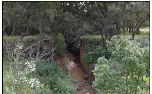
Pont détruit du Pas du Cerf
